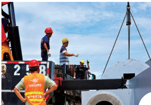
吊装车间设备 阮刚石
